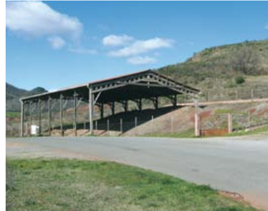
La halle de la Lieude, sa charpente en treillis de bois et sa toiture parallèle à la voie et aux pentes du relief.
