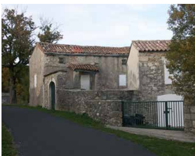
Mas de la Vieille à Sorbs: Maçonnerie en pierres destinées à être enduites pour le bâtiment d'habitation, et à rester apparentes pour l'annexe transformée en habitation. Mur de clôture à l'alignement de la voie dans le prolongement des bâtiments délimitant une cour fermée Accès à l'habitation par un «bolet», composition simplifiée de la façade, avec des ouvertures plus hautes que large.
